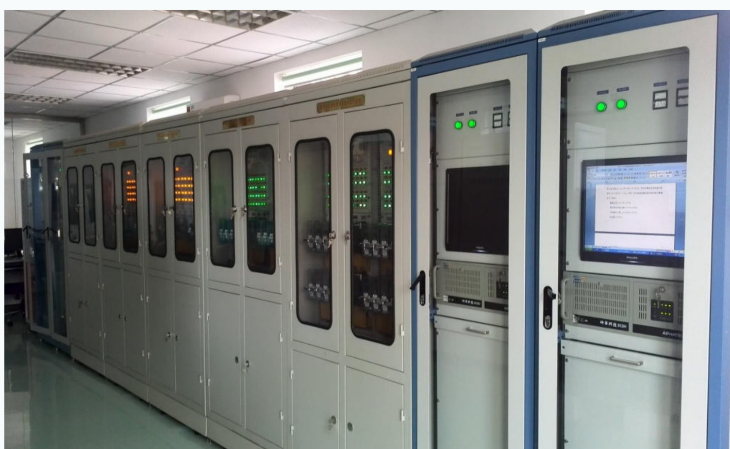
为“中国通号-沈阳铁路信号有限责任公司”建立的电器可靠性实验室
