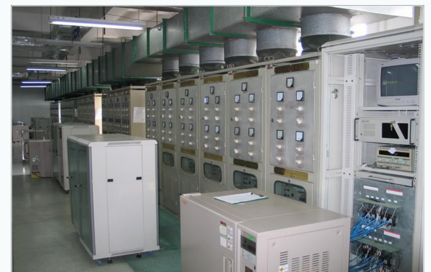
为“厦门宏发电声股份有限公司”建立的继电器电寿命试验中心
